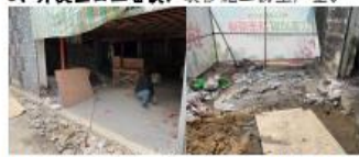
4、邢集社区拆迁工地：拆除施工扬尘严重。
