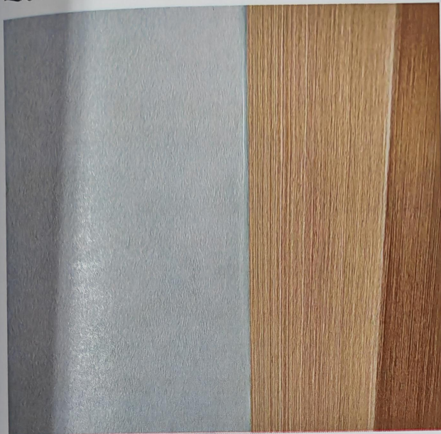
附件 4: 六楼七楼走廊乳胶漆、科普馆的壁布接缝、实木柜体与墙体连接处瞎缝等质量缺陷修复整改照片
